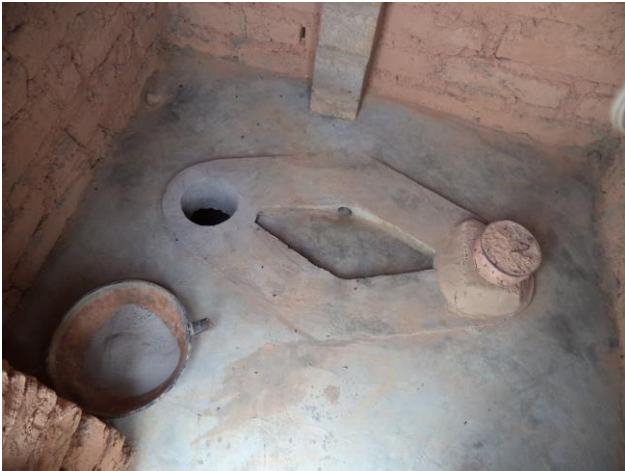
Toilette sèche ECOSAN à double fausse avec récupération séparé des urines
