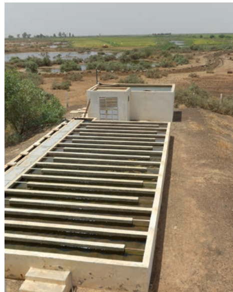
Station de traitement des eaux de surface au Sénégal
